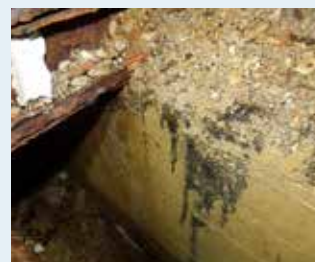
Les soubassements des bassins, rongés par la rouille, ont dû être remplacés en 2017
